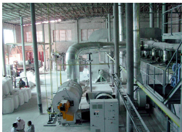
Bild 2 Moderne und effiziente Trocknungsanlagen für das Kaolingranulat
